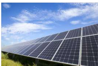
Instalacje wytwarzania OZE w różnych obiektach
