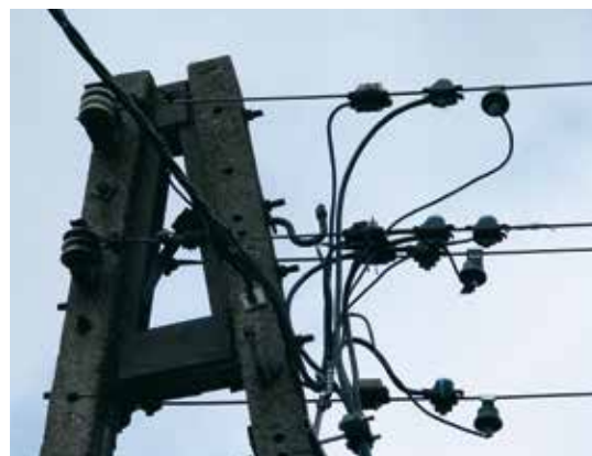
koniec linii napowietrznej nn
