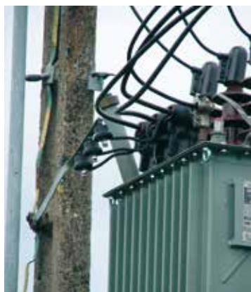
początek linii napowietrznej nn
