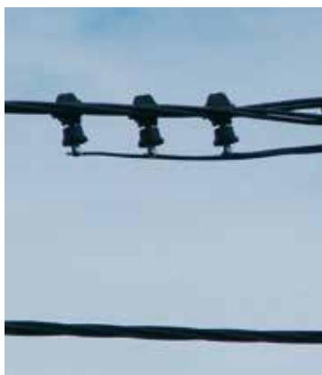
linia główna 1 komplet ASA co 500 m
