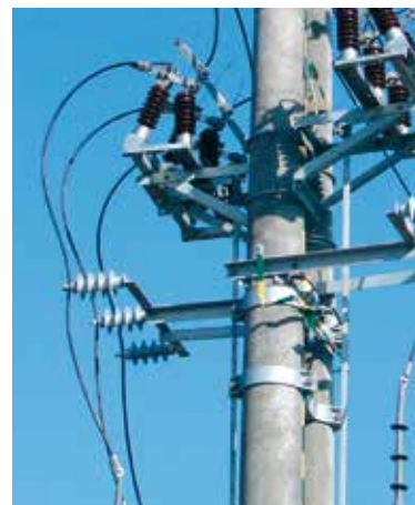
zabezpieczenie kabla SN – zejście z linii napowietrznej
