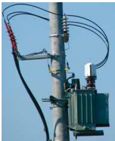
zabezpieczenie uproszczonej stacji transformatorowej 15/0,4 kV
