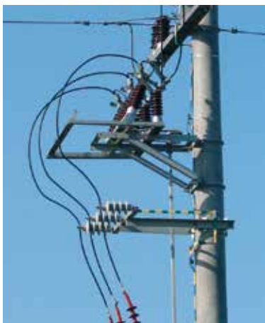
zabezpieczenie kabla SN – zejście z linii napowietrznej
