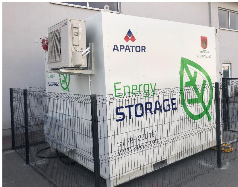
Magazyn energii 100 kW
